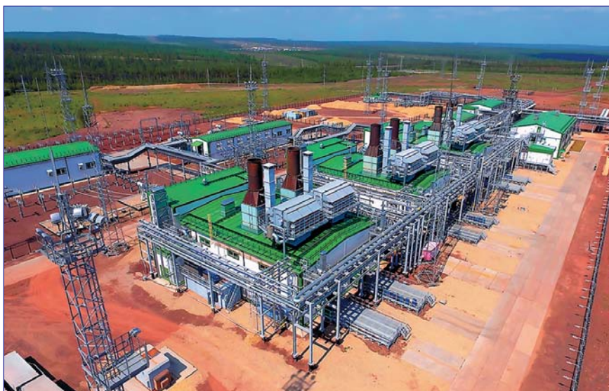
Электростанция собственных нужд ЭГЭС-48 на базе пермских газовых турбин
